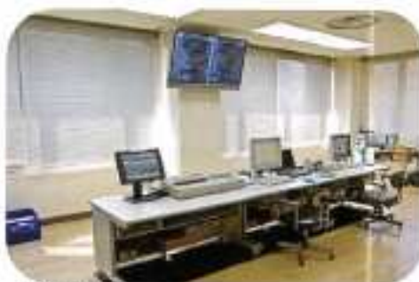
遠方操作盤 ゲート等の施設を事務所より遠隔操作する。
