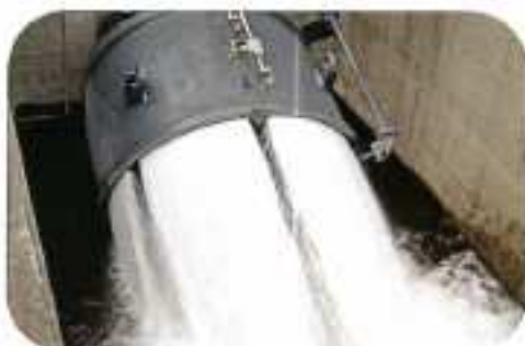
ホロージェットバルブ 取水ゲートから取水された水を調節する。
