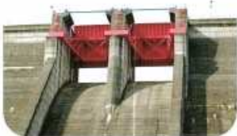
洪水吐ゲート 貯水池の水位を調節するために使用する。
