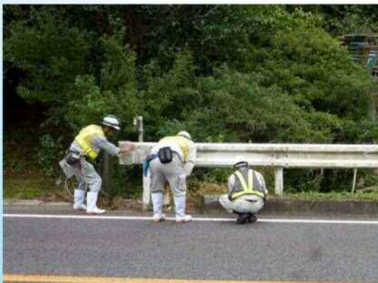
路面の損傷確認状況
