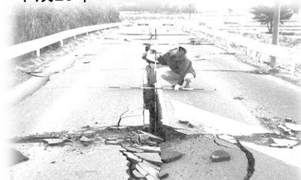
東日本大震災における道路被災状況
