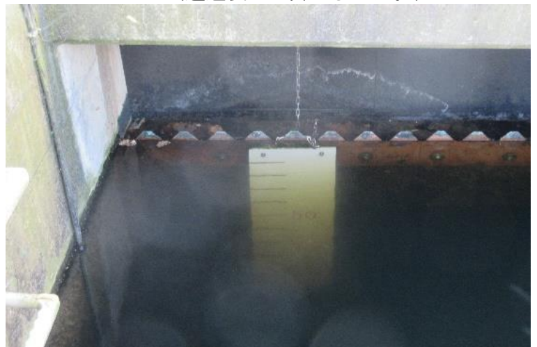
最終沈殿池 (透過度が上昇しました。)
