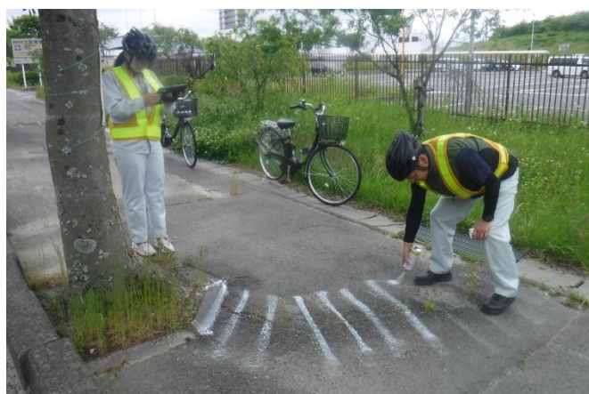
亀裂状況確認中
